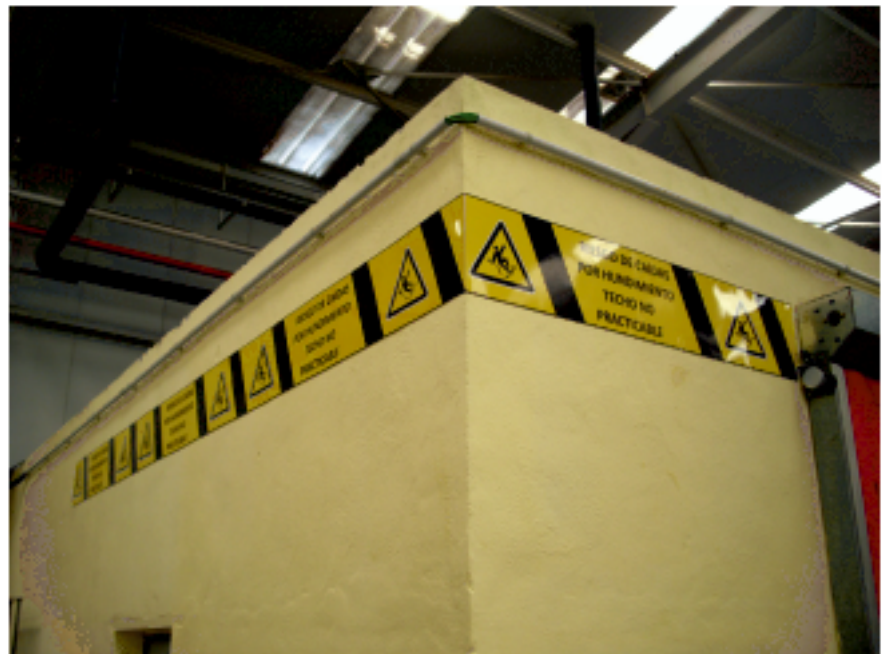
Banda riesgo de caídas por hundimiento
